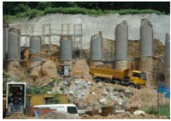
圖42： 進行斜坡工作時因涉及多個分工階段，或要提供臨時工作通道，甚至是山坡範圍廣闊、高俏，施工情景看似凌亂，是難於避免的。圖中所見的斜坡，是用大口徑樁柱作為承托的一類例案。
