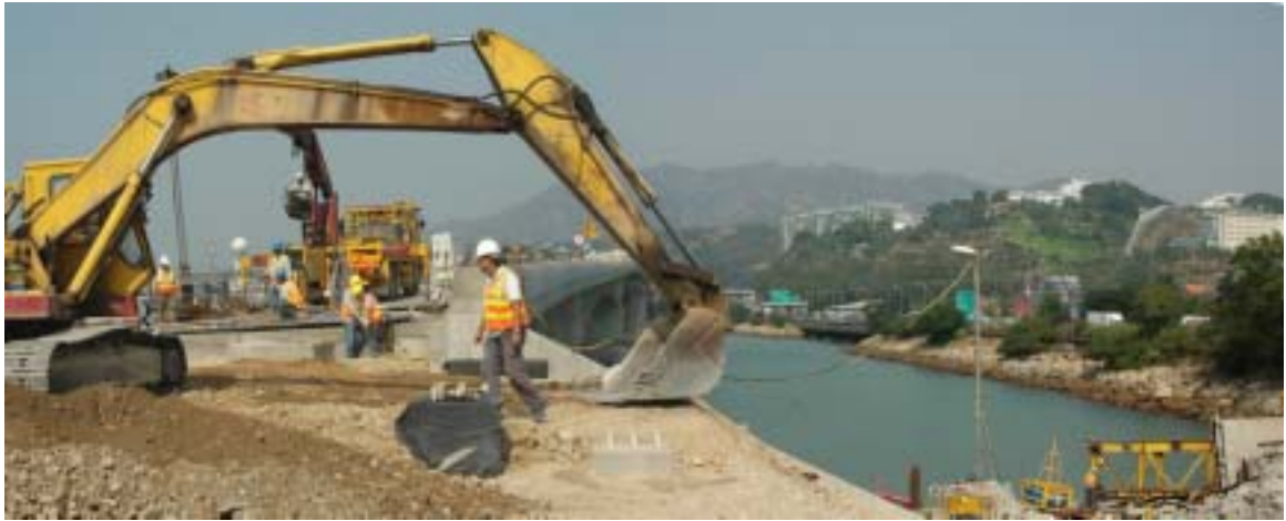
圖20： 2006年底在大欖角跨海橋的座基位置所見，工程人員正就大橋的後期接駁如伸縮接口、鋪設柏油路面或交通訊號裝置等進行完工前的安裝工作。
